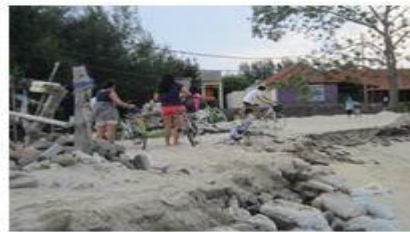
Gambar 2. Kondisi jalan rusak akibat abrasi
