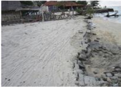
Gambar 5. Kondisi jalan rusak
